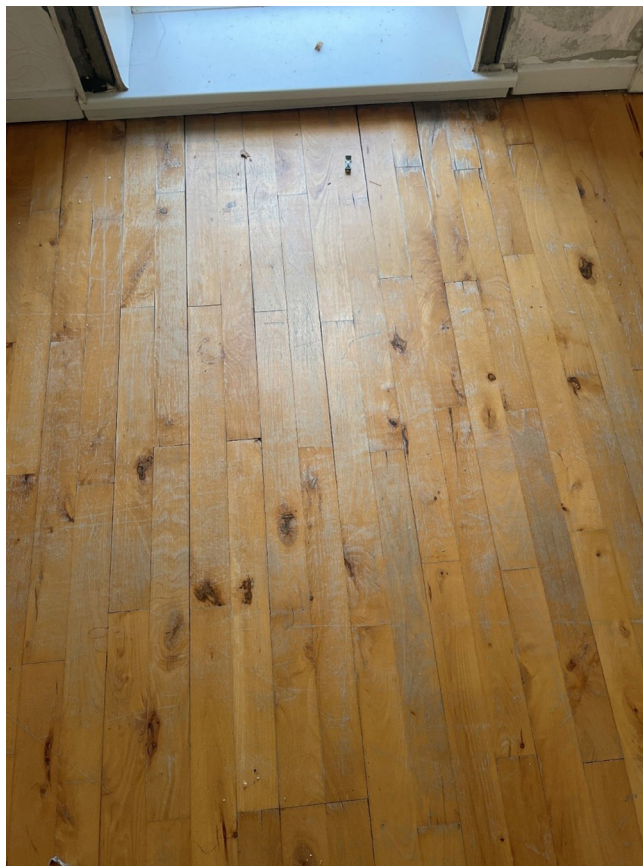
Nær de nordlige vinduer var gulvene præget af vandskader fra regn
